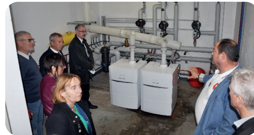
Mise en place de deux chaudières à condensation au groupe scolaire du Valat du Sicard.
